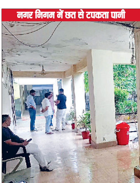
नगर निगम में छत से टपकता पानी
